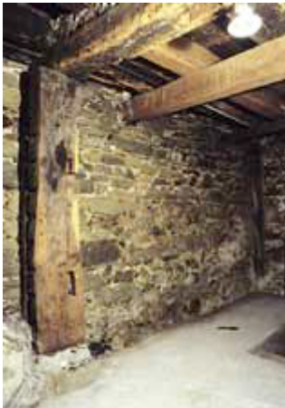
Abb. 8 Haus St.-Oswalds-Gasse 10, Erdgeschoss, Südwand: Auf dem originalen Mittelständer liegt der Unterzug auf. Die vertikale Nut im Ständer und das Kopfholz auf der Ständeraussenseite sind noch vorhanden. Sekundär sind der Steinsockel und das Fundament unter dem Ständer sowie die von aussen an den Bohlen-Ständerbau gemauerte Steinwand, in der horizontale Negative von Wandbohlen sichtbar sind
