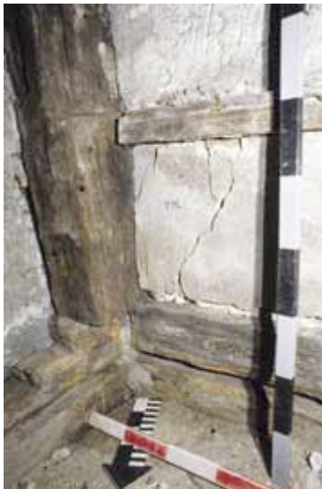
Abb. 10 Haus St.-Oswalds-Gasse 10, erstes Obergeschoss, Raum 10, Südwestecke: Der originale Ständer ist mit Fase und auslaufendem Schildchen verziert. Er ist in die südliche Aussenschwelle eingezapft, in welche die Schwelle der ehemaligen Westwand des Raumes stösst. Während die Bodenbretter unter dieser durchlaufen, sind sie in der Aussenschwelle eingefalzt. Über der Oberkante des bereits entfernten Mörtelgusses sind die Nuten zur Aufnahme der Bodenbretter sichtbar
